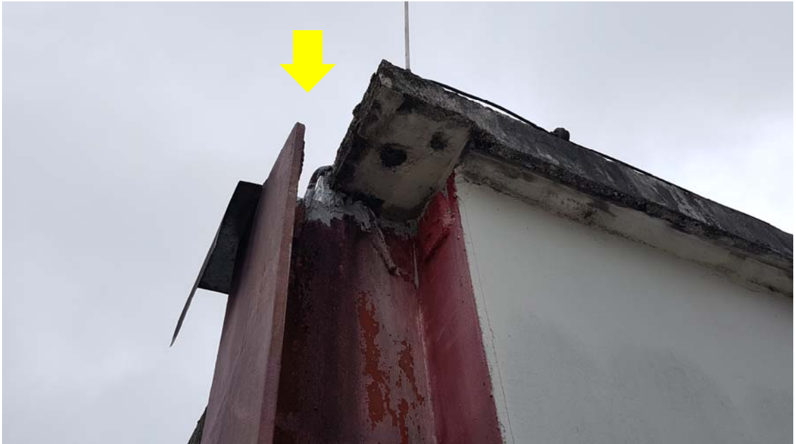
Parte da secção do pilar descoberta pela laje de cobertura da torre das caixas d'água Lado da fachada frontal
