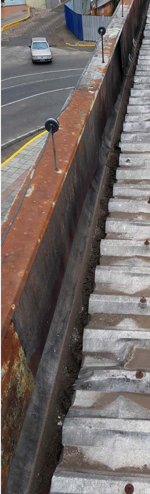
Corrosão nos rufos-capa
