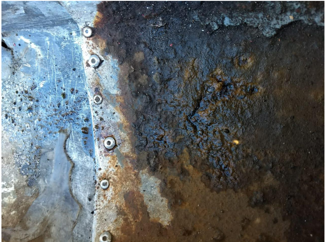
Corrosão na chapa de aço galvanizado do fundo da calha
