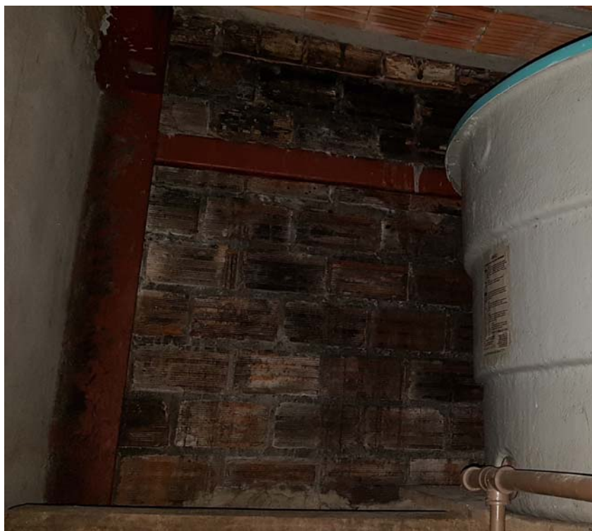
Marcas de penetração de água na parede interna da torre das caixas d'água
