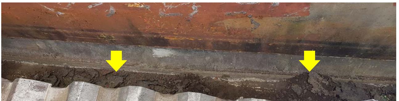
Acúmulo de terra nas calhas
