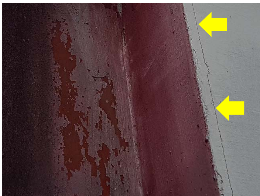
Fissuras no contato entre os perfis da estrutura e a alvenaria
