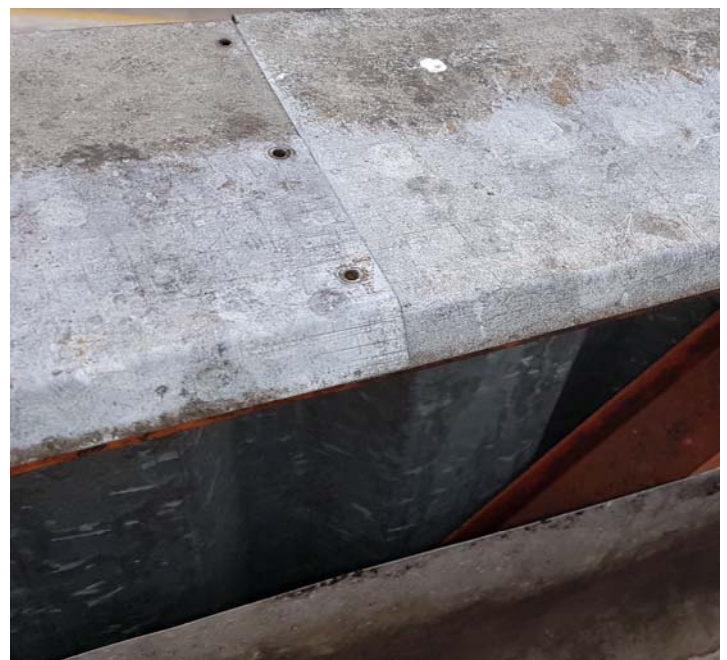
Falta de fixação e mastique na emenda dos rufos-capa
