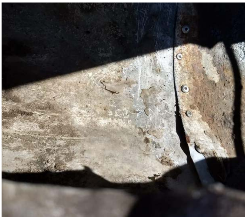
Rasgamento da chapa e dano na emenda das calhas
