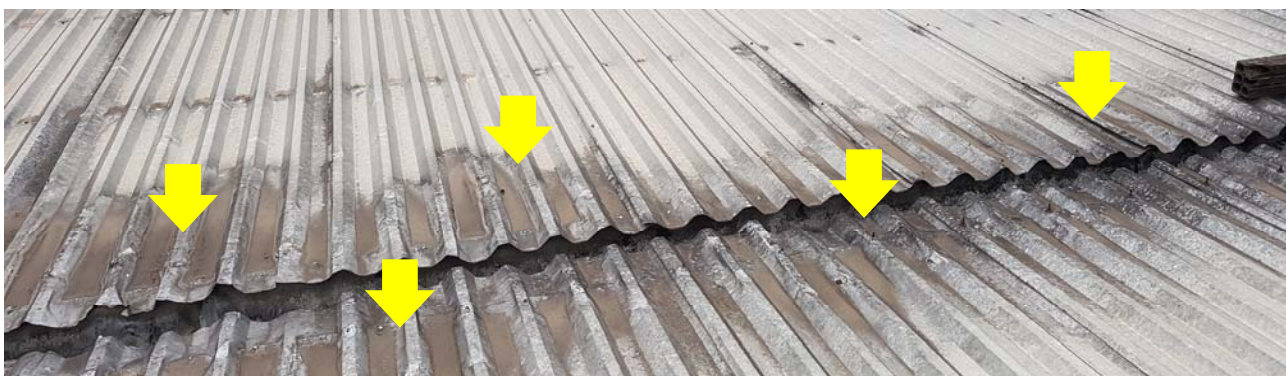
Extremidade das telhas amassadas, na proximidade das calhas – as áreas escuras são de acúmulo de poeiras e indicam as depressões causadas pelo tráfego de pessoal
